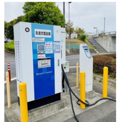
図 3.1-5 急速充電設備
