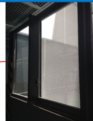
エコシャフト側 自然換気窓
